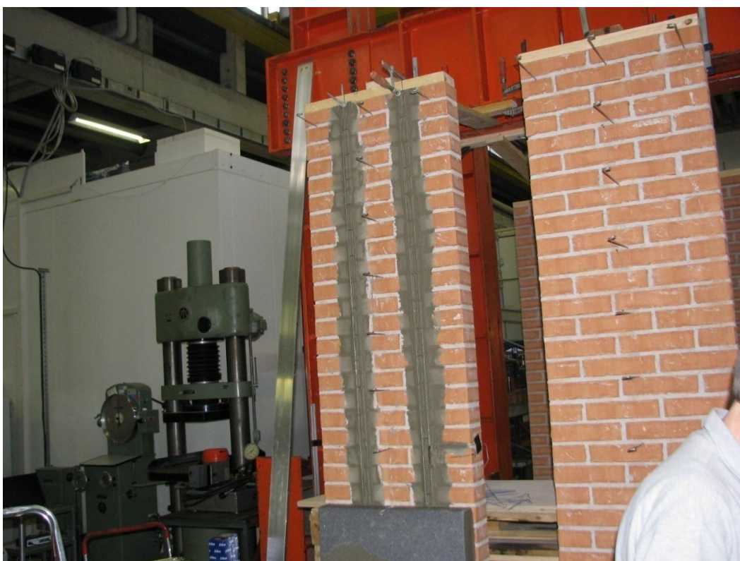
Fig. 14. Multiklæb påsmøres i baner, hvor armeringen skal placeres, hvorefter armeringen "trykkes" ind i denne
